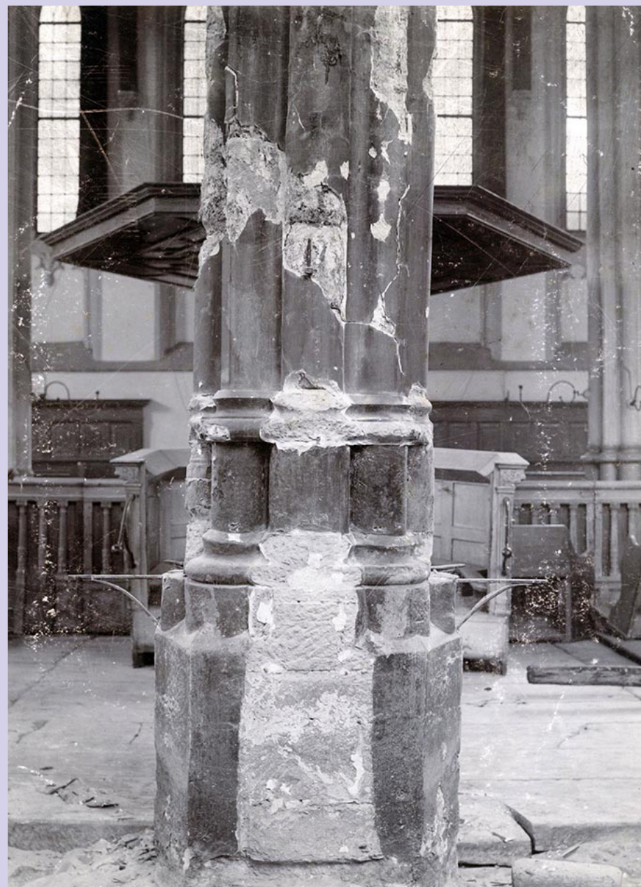
Boven: Sommige kolommen waren heel ernstig beschadigd
